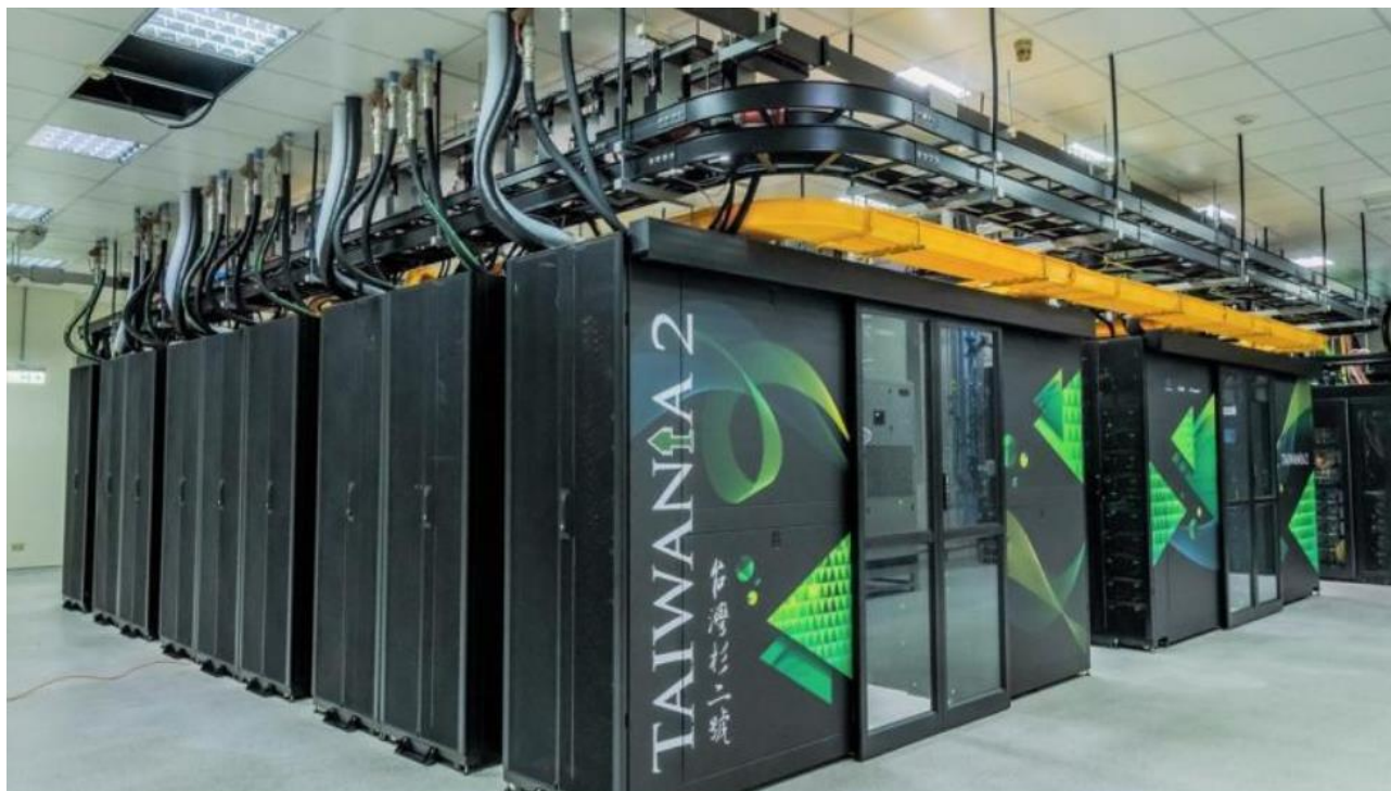
Figur 10 Væskekjølt superdatamaskin (ref: Asetek)
