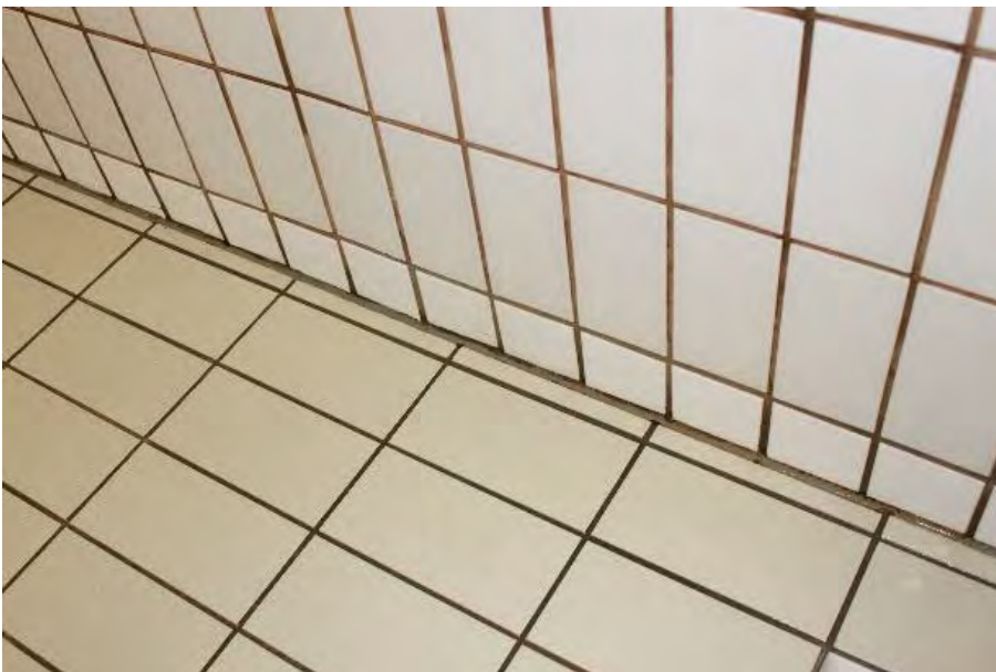
Bilde 24 Flisene bærer preg av mye lapping og fuging for å holde anlegget i drift.
