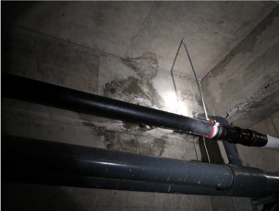
Bilde 38 Indikasjoner på lekkasjer.
