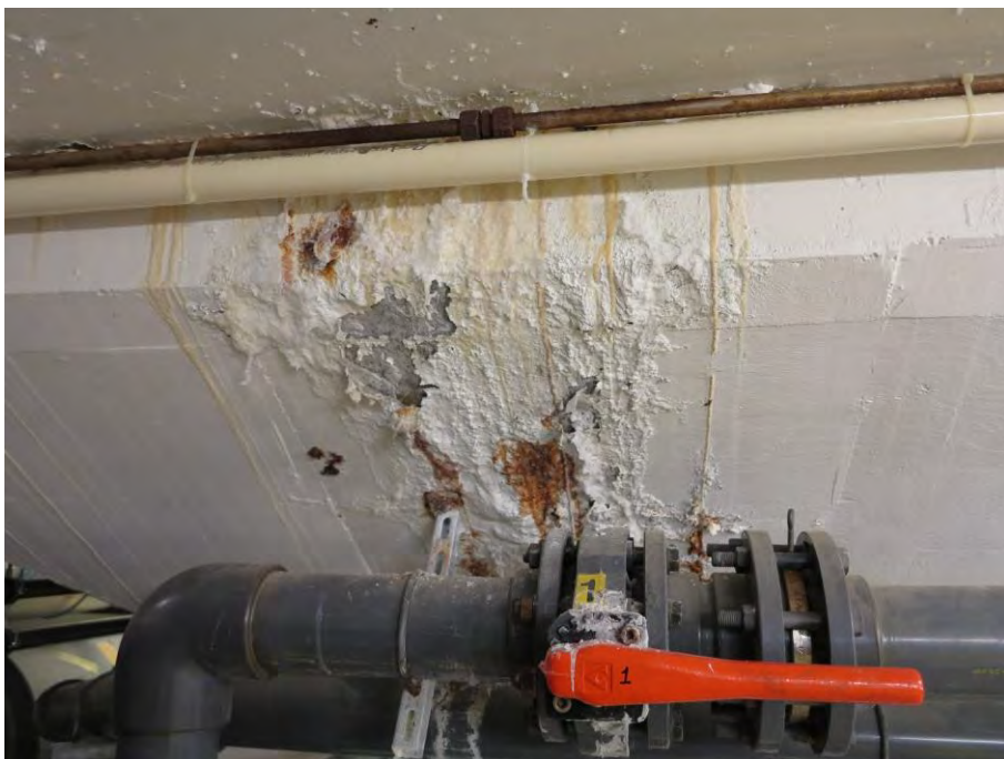
Bilde 31 Nærbilde av lekkasje på foregående bilde.
