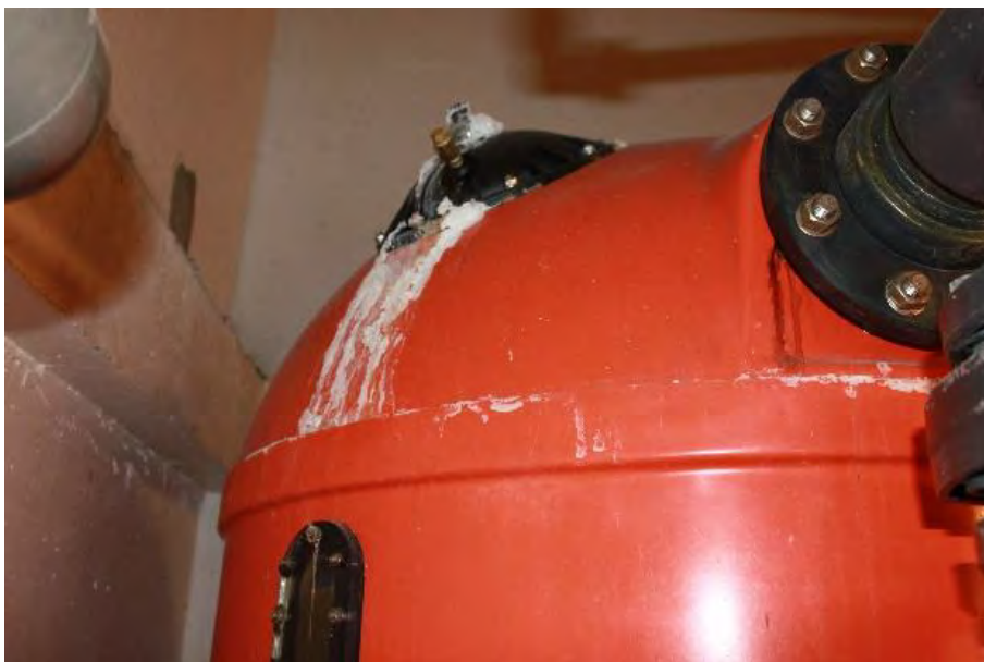
Bilde 39 Prosessanlegget er modent for utskifting sammen med automatikken. Sandfilterne skiftes også ut med nye og det bør etableres ny spylevannstank.
