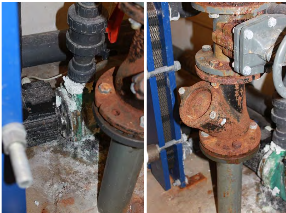
Bilde 36 Prosessanlegget er modent for utskifting sammen med automatikken.
