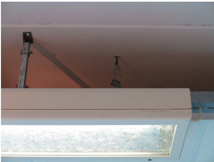
Bilde 19 Noe korrosjon på oppheng
