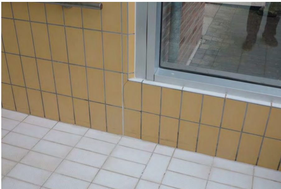
Bilde 4 Overgang glassfasade og vegg – flisen har sprukket i hjørnet.
