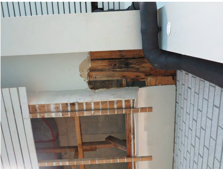
Bilde 7 Åpning i taket på grunn av lekkasje
