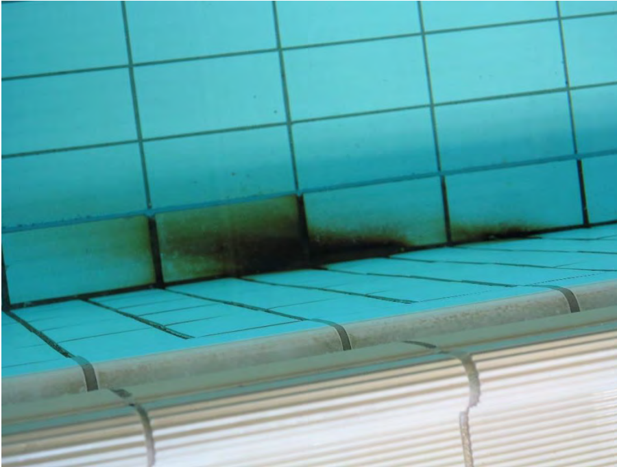
Bilde 18 Kraftig utfelling av det som trolig er rust fra korrodert armering, i overgangen mellom vegg og bassengbunn.
