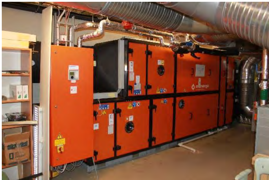
Bilde 43 Aggregatet er fra 2016 og har kapasitet på 9 500 m 3 /h. Anlegget fremstår i god stand og bedømmes å ha en restlevetid på ca. 15 år.
