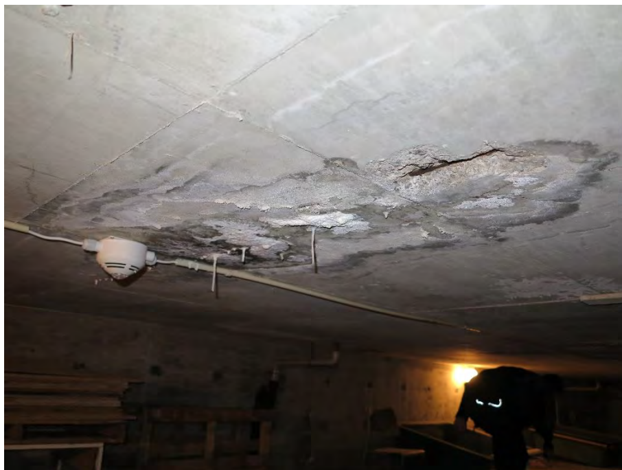
Bilde 44 Tydelige rester etter drypplekkasjer med stalagtitter, avdekket avmering på grunn av armeringskorrosjon i samme område.
