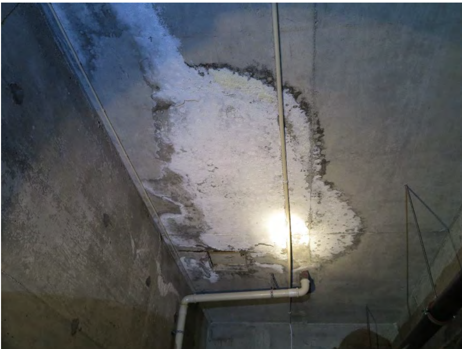
Bilde 39 Indikasjoner på tidligere lekkasjer.
