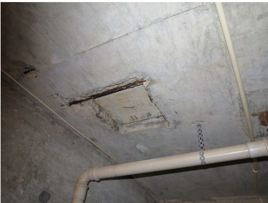
Bilde 41 Frilagt korrodert armering rundt gjenstøpt åpning.
