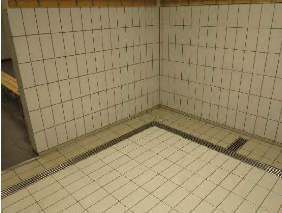
Bilde 25 Mulig at slukrenner og slukplasseringer må etableres på ny for å lede bort vannet på en grei måte fra dusjen og inn til garderoben.
