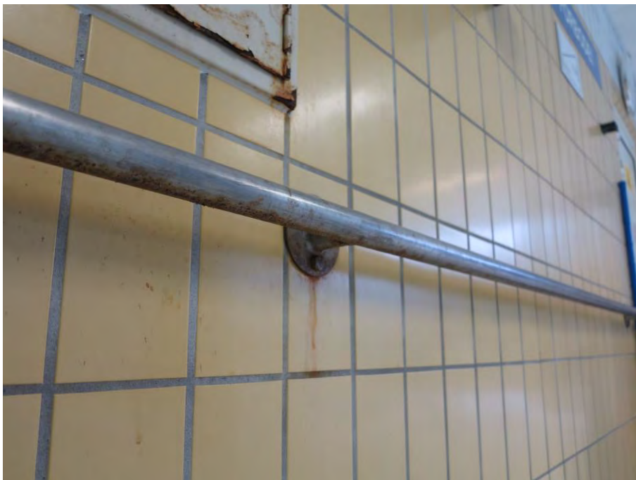
Bilde 15 Korrosjon på brannslangeluke og håndløper. Dette skyldes hhv. for dårlig korrosjonsbeskyttelse av luke, og for dårlig vedlikehold av rustfri håndløper som må pusses regelmessig for å holdes korrosjonsfri.
