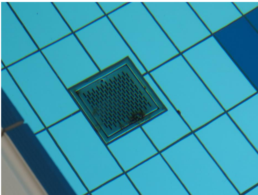
Bilde 13 Korrosjon på rist i avløpet.
