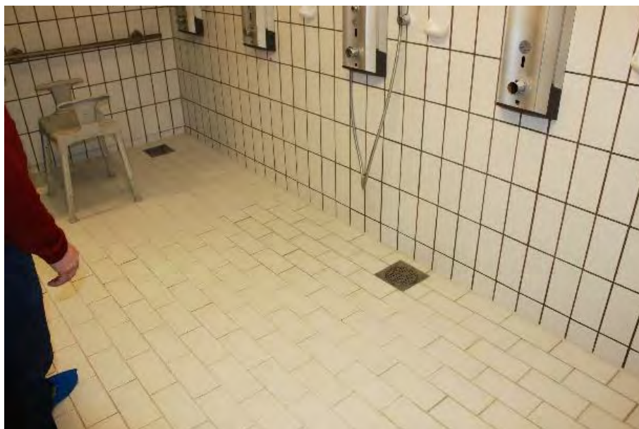
Bilde 23 Slukene er ikke logisk plassert og det er ikke tilstrekkelig fall på gulvet slik at vannet nesten havner på andre siden av rommet når noen dusjer
