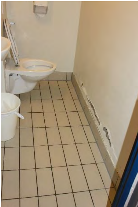
Bilde 19 Fuktutslag i toalett inntil bassengrommet, trolig på grunn av manglende membran på gulv.
