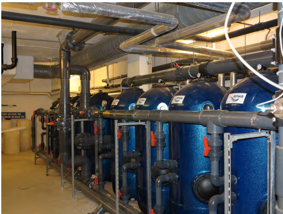
Bilde 32 Relativt nyinstallerte sandfiltere
