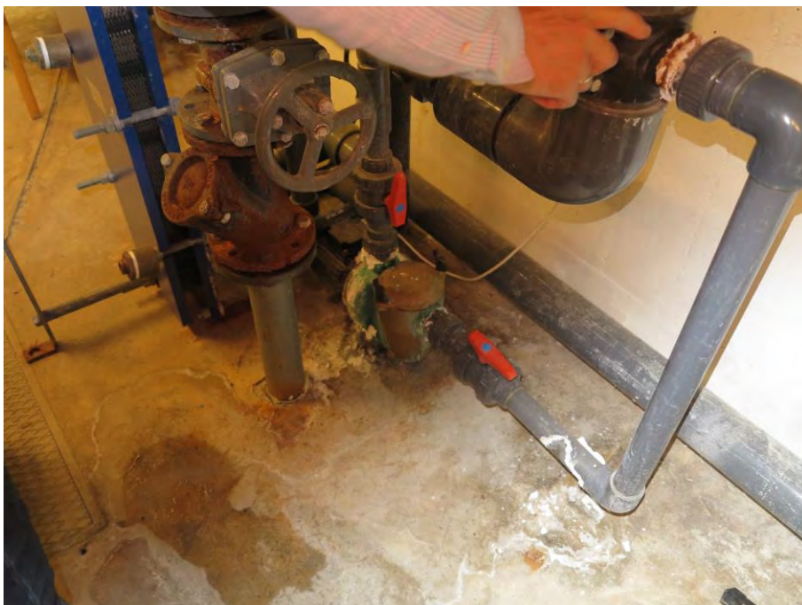
Bilde 32 Lekkasje og korrosjon
