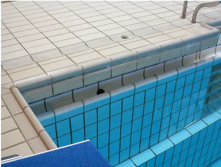
Bilde 12 Kalkutfelling på bassengkant tyder på manglende fuktsperre på gulvet rundt bassenget.
