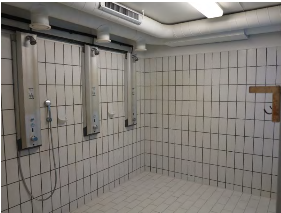
Bilde 27 Dusjer med lite hensiktsmessige fallforhold.
