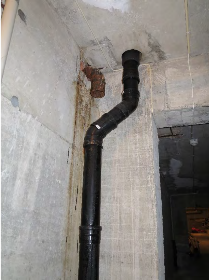
Bilde 37 Taknedløp med utvendig kondens fordi det er uisolert.
