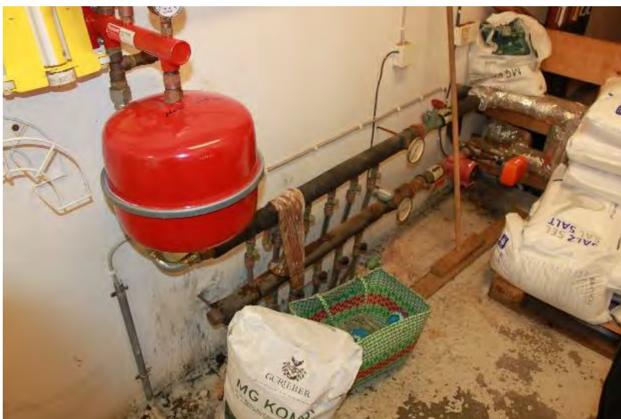
Bilde 42 Gulvvarmeanlegget til svømmehallen har ingen hensikt og bør bare kobles fra det øvrige anlegget.
