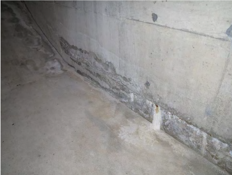
Bilde 36 Lekkasje i overgang bassengvegg og bassengbunn.
