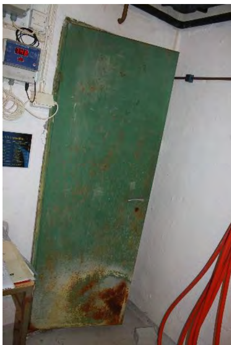
Bilde 29 Teknisk rom under bassenget bærer preg av at det har vært utsatt for et tøft klima over mange år. Her mangler det både utjevningsbasseng og spylevannstank.
