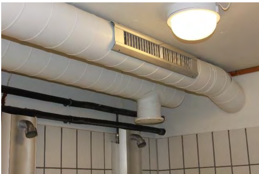
Bilde 22 Varmt og kaldtvannsrørne til dusjene bør legges om og heves opp mot taket. Her må de enten kasses inne eller mantles
