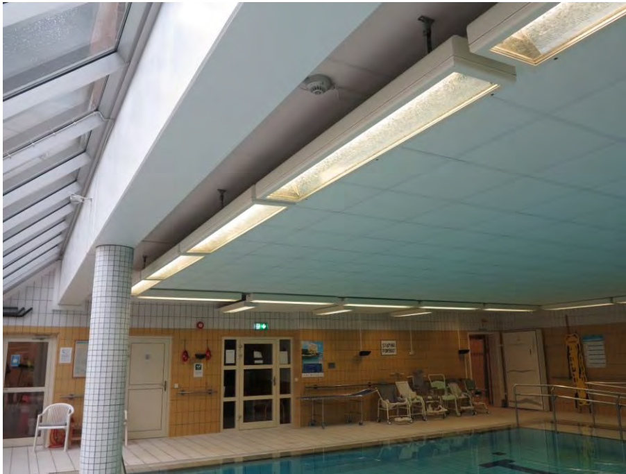
Bilde 17 Belysning rundt periferien av bassenget slik at det skal være mulig å gjøre vedlikehold uten å være ute i vannet.
