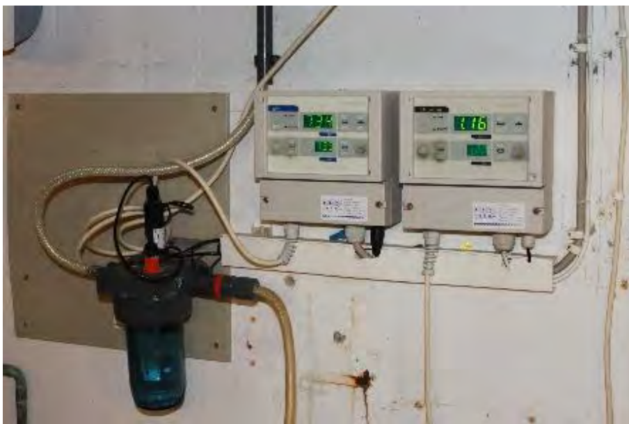
Bilde 40 Prosessanlegget er modent for utskifting sammen med automatikken.
