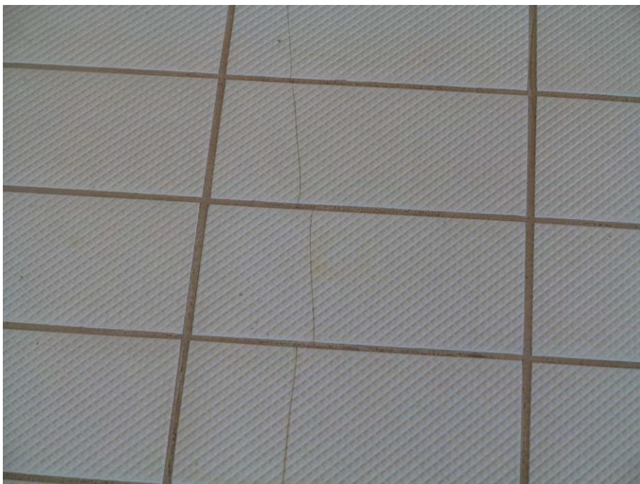
Bilde 14 Sprukne fliser, sannsynligvis forårsaket av bevegelser i underlaget i og med at det strekker seg over flere fliser.
