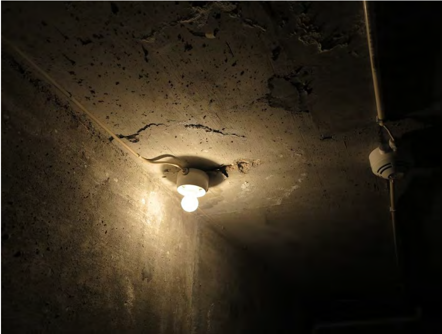
Bilde 40 Oppsprekking, trolig på grunn av armeringskorrosjon.
