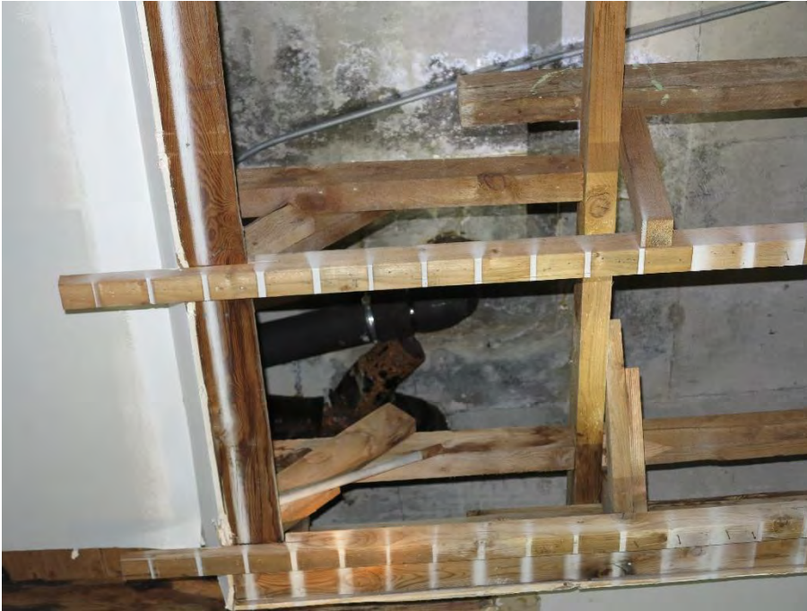
Bilde 8 Nærbilde av slukgjennomføring hvor det har vært lekkasjer. Vi ser restene etter gammel rørføring.
