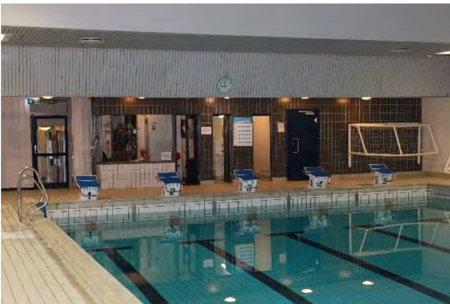
Bilde 9 Himling og spilekledning på vegg bak startblokkene kan med fordel skiftes ut med nye.
