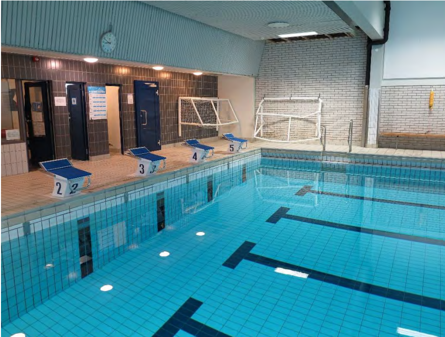
Bilde 6 Dyp side med startpaller. Vi kan også se åpnet himling etter lekkasjer rundt sluk.
