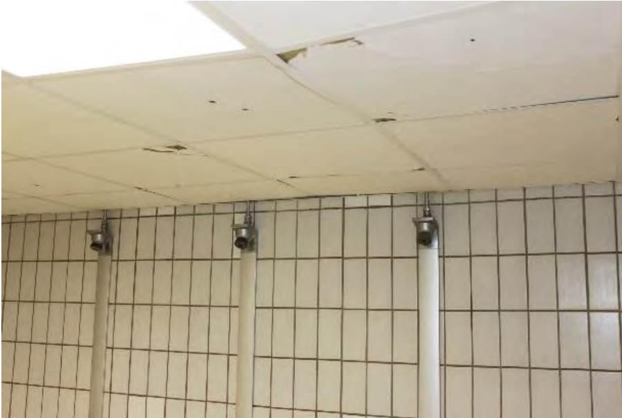
Bilde 23 Dusjene bør totalrenoveres med nye fliser på gulv og vegger samt ny himling.
