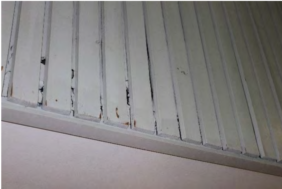
Bilde 10 Spilekledning på vegg. Denne er klar for utskifting.
