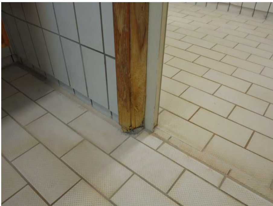
Bilde 29 Trematerialer ned mot gulvet trekker vann og råtner til slutt opp.
