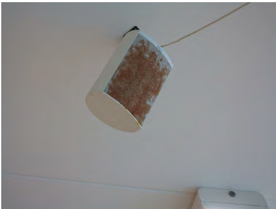
Bilde 20 Korrosjon på høyttaler i taket. Tilsvarende høyttaler i andre deler av lokalet var korrosjonsfri, uten at vi umiddelbart kan forklare hvorfor.
