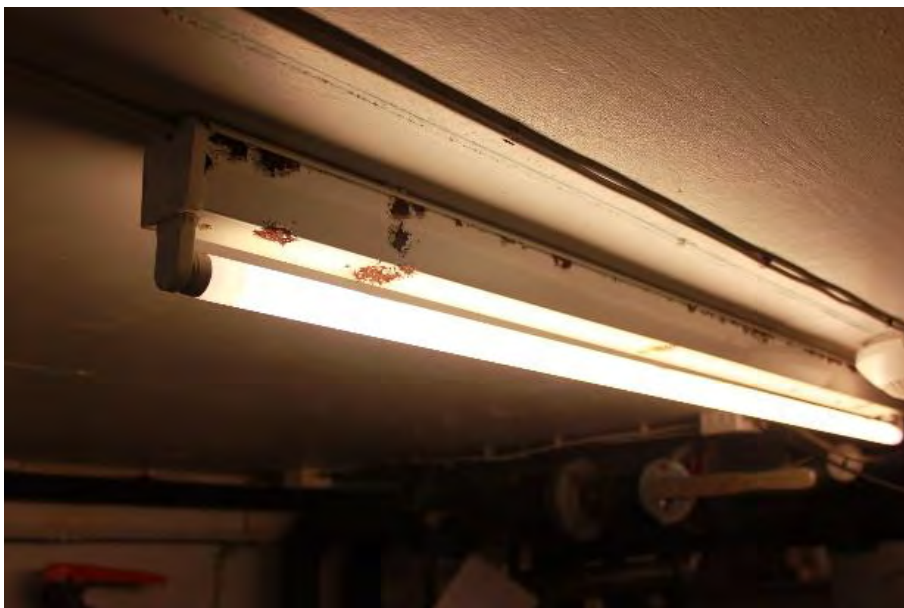
Bilde 41 Korrosjon på lysarmaturer, som er modne for utskifting.
