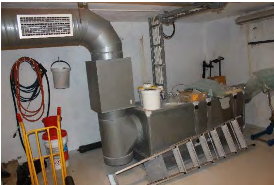
Bilde 31 Tilluftsaggregatet til prosessrommet under bassenget har kun tilluft uten gjenvinning og med elektrisk varmebatteri. Her er det mulig å spare en del kWh i året på nytt anlegg.
