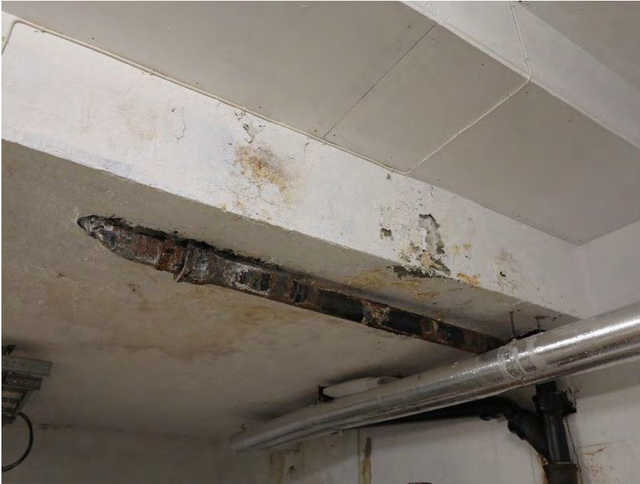
Bilde 34 Rester etter lekkasjer.
