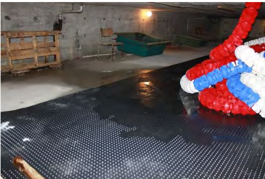
Bilde 43 Det er behov for å etablere en bedre ordning for oppsamling av baneskillerne og vannsølet disse medfører.
