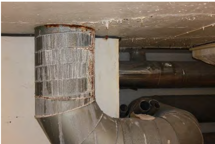
Bilde 35 En del kanaler er angrepne av rust som følge av lekkasje fra etasjen over og bør skiftes ut samtidig som lekkasjene fikses.
