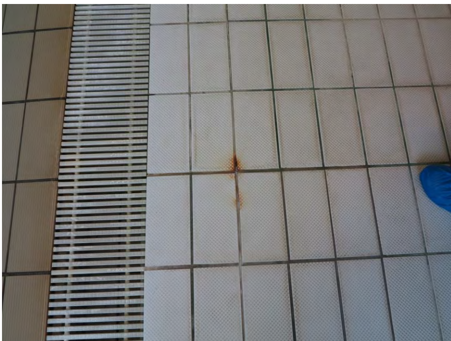
Bilde 10 De sklisikre flisene rundt bassenget fremstår som skitne. Rødfarge kan være noen form for korrosjonsrester, men vi er usikre. Den aktuelle fugen er en mykfuge.
