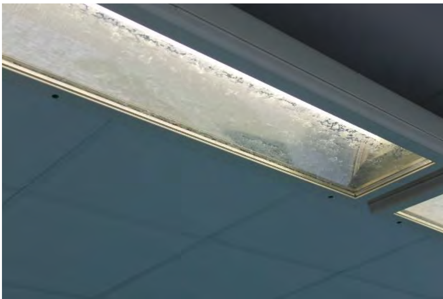
Bilde 18 Lysarmaturene er ikke rengjort og kan med fordel skiftes ut med nye
