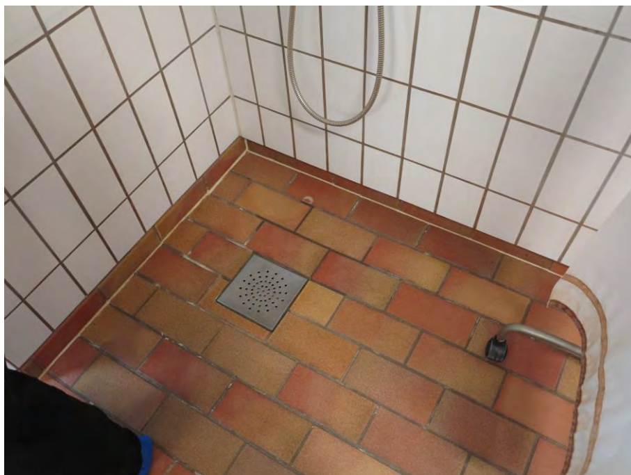
Bilde 26 Dusj i HC-garderobe. Her ligger det originale gulvflis fra byggetidspunktet.
