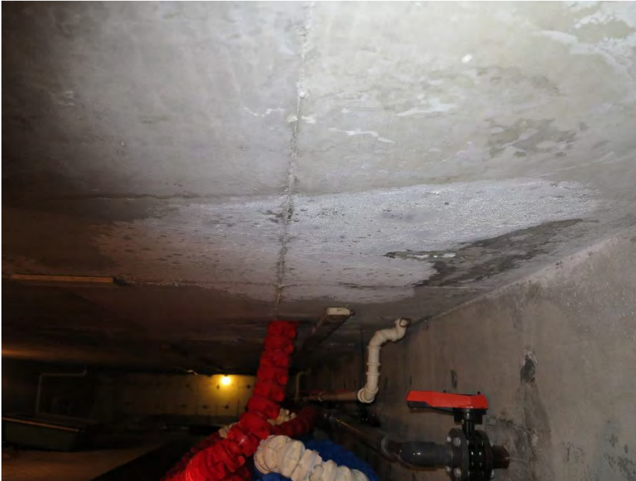
Bilde 42 Kalkutfelling i taket
