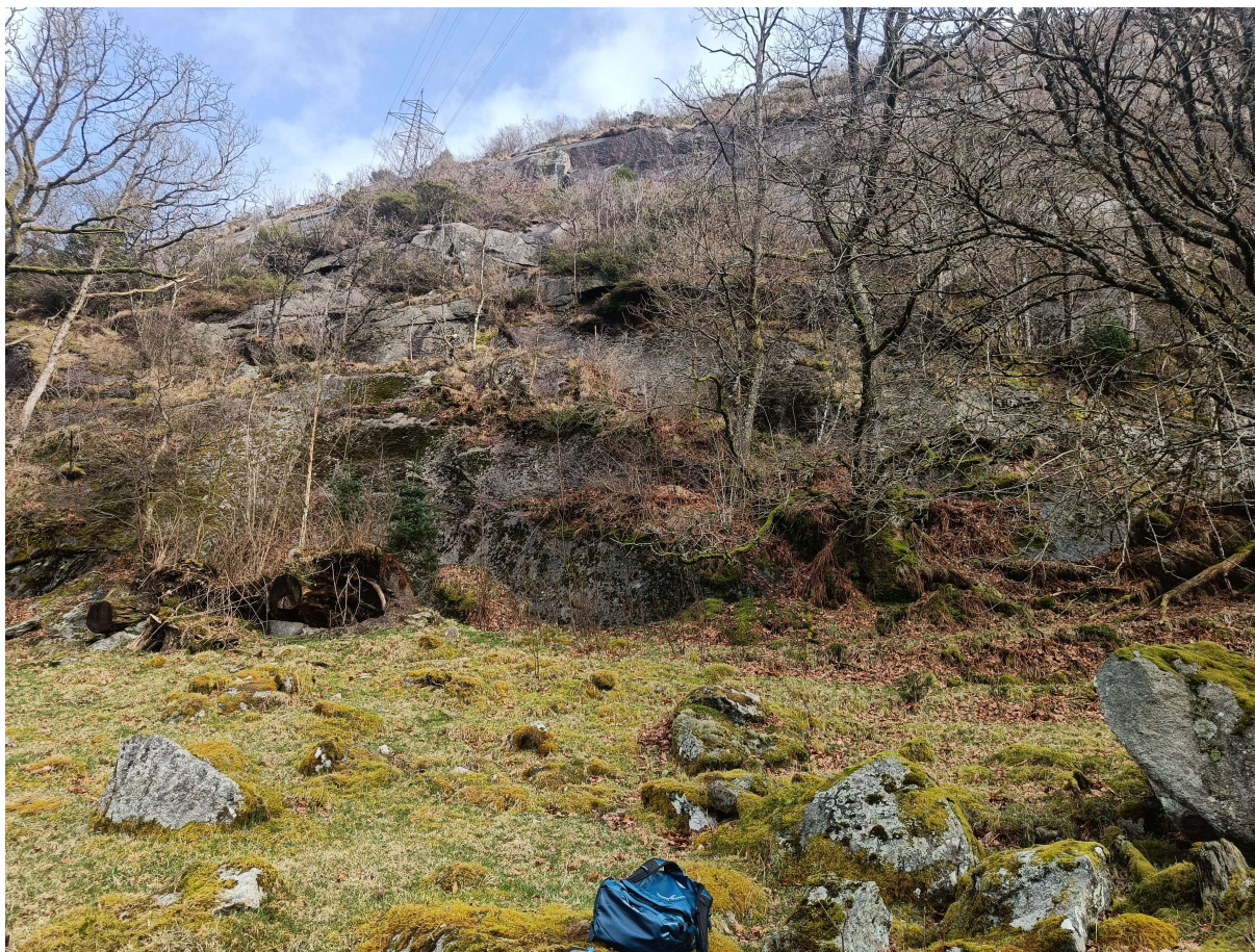
Figur 3.13 Nedfallen blokk i området for påhugg vest - særlig alternativ. Det tolkes å være fare for nedfall av blokk over påhugg i området.
