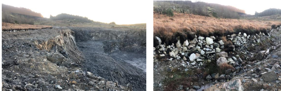
Figur 2-12: Foto som viser avskjæringsgrøfter som leder overflatevann bort fra dagbruddet. Kilde: Multiconsult
