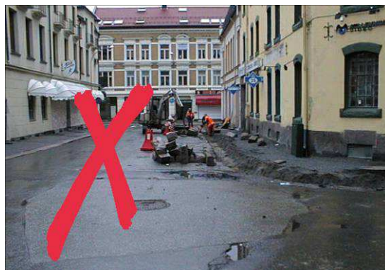
Manglende skilting og sperring.
