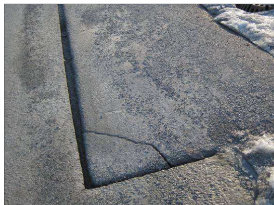
Åpen skjøt pga. manglende klebing og fortanning.
