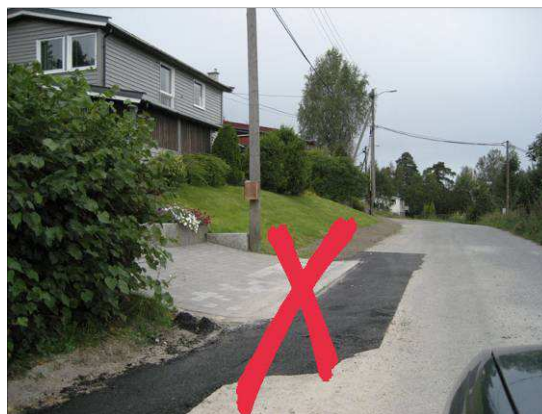
Uønsket endring av grøftetrasé.
