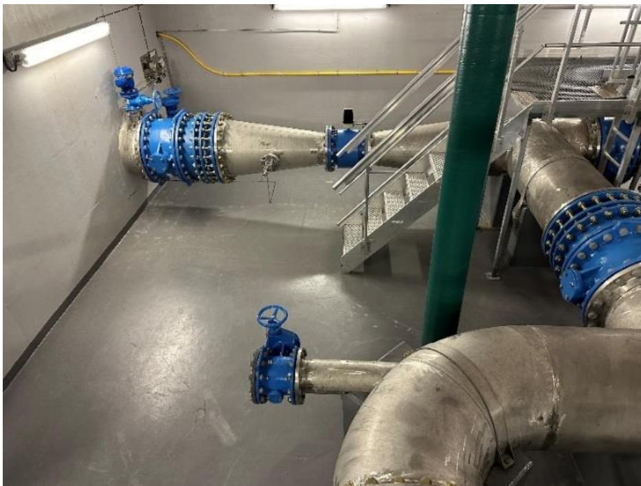
Figur 2-6: Ventilkammer 1126 i sørvest for prosjektområdet med ledig uttak for påkobling.
