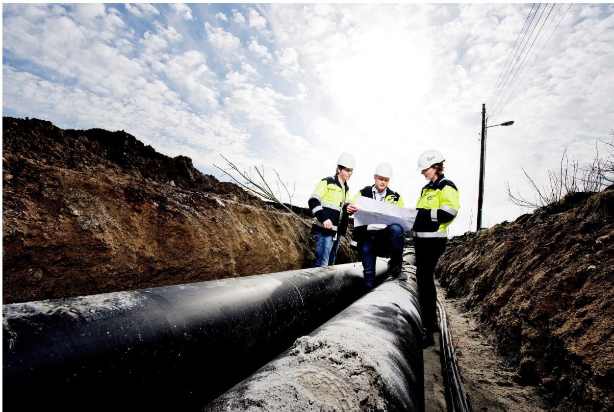
Planlegging av fjernvarmeanlegg (Foto: Fredrik Ringe, flickr)
