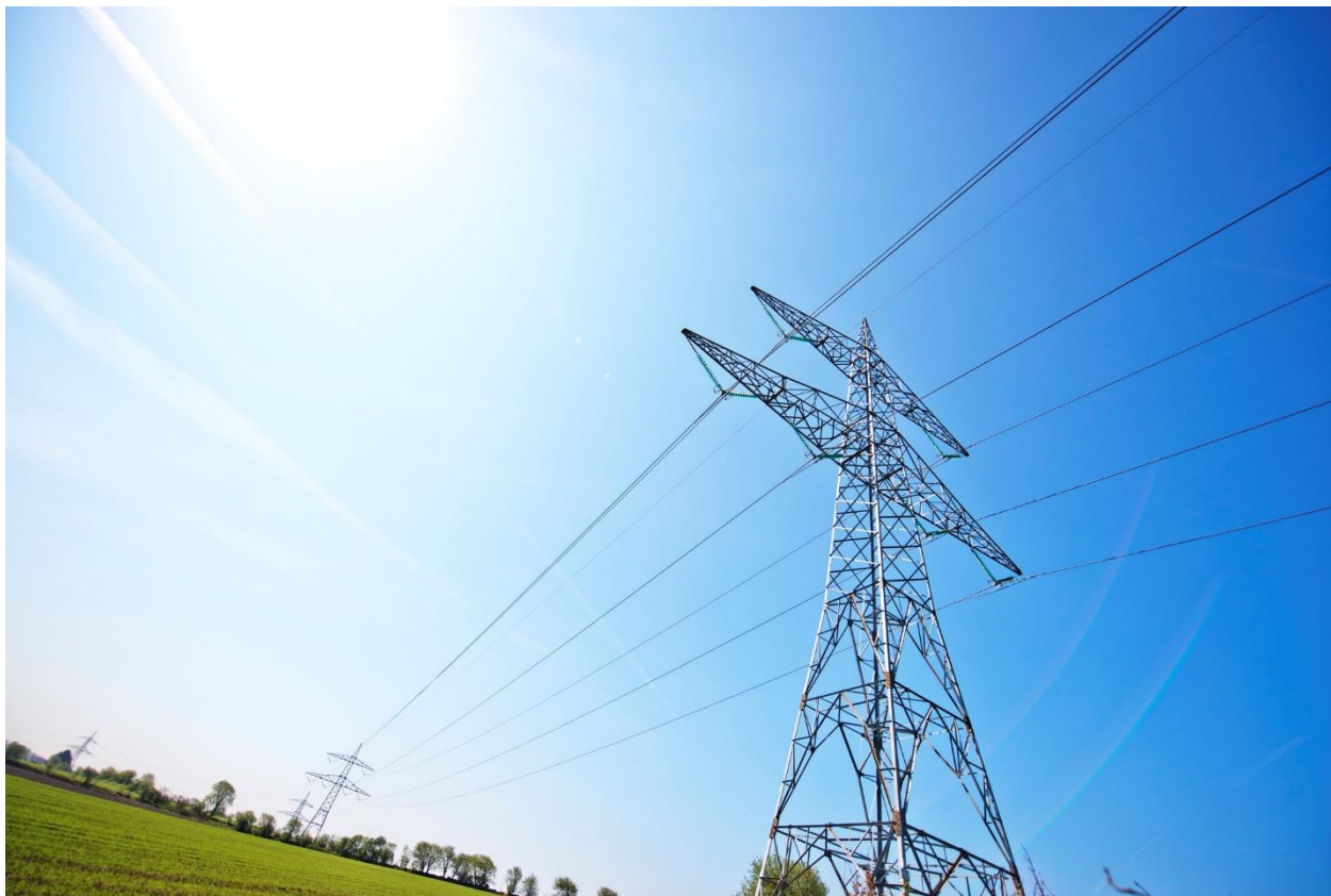
300 kV linjene til Statnett inn mot Stavanger ved Forus (Foto Fredrik Ringe, februar 2012)
