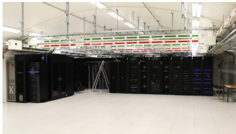
Datalagring i fjellhallen Green Mountain i Rennesøy.
