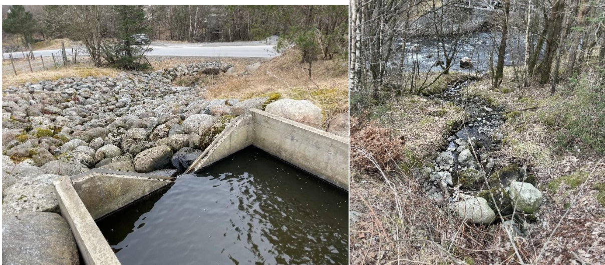
Figur 35: Utløpsanordning og steinsatt flomløp fra rensedammene sett mot Kvernalandsvegen og utløpet nedstrøms Kalbergveien.
