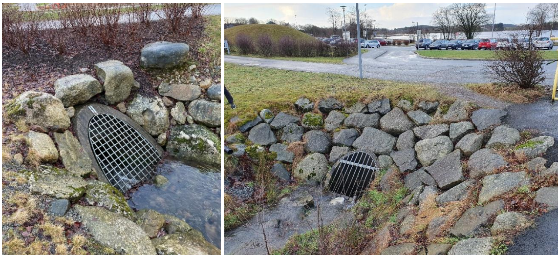
Figur 40: Eksempel på rister som bør byttes fordi de har stor fare for gjentetting med tverrgående staver og lite ristareal ift. rør som reduserer kapasiteten.
