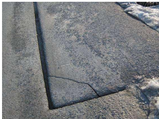
Åpen skjøl pga. manglende klebing og fortanning.
