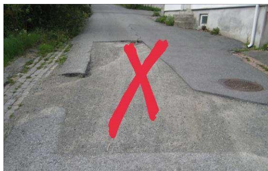
Feil utført skjæring; Entreprenør har midlertidig ansvar for vedlikehold av dekket.
