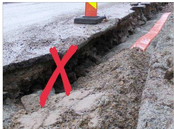
Utrasing av grøfteside. Her må det foretas skjæring av asfalt og justering av grøfteskråning
