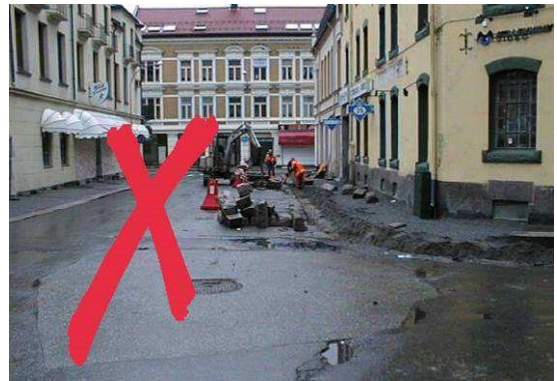
Manglende skilting og sperring.
